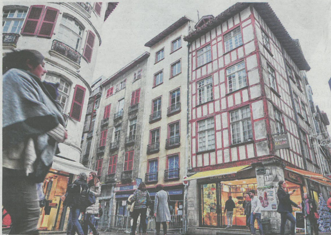
Un périmètre de sécurité écarte les passants des deux boutiques fermées, dans la rue Port de Castets. Des fissures inquiétantes ont été constatées sur les murs porteurs. PHOTO BERTRAND LAPÈGUE
